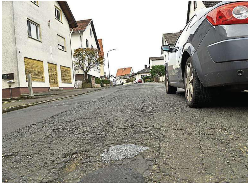
Müssen marode Straßen – wie zum Beispiel die Bitzenstraße in Lützellinden – saniert werden, bitten Kommunen meist auch die Anwohner zur Kasse. Das sorgt immer wieder für Ärger.
